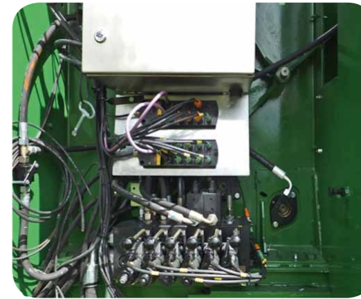
Hydraulik und Rechnersteuerung
